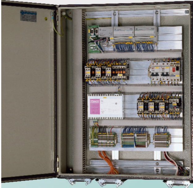
Steuerschrank für dezentrale Funktionsgruppe einer Laserschneidmaschine, konfektioniert mit fortschrittlichem LSC-Verdrahtungssystem.
